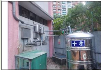
說明：校園屋頂導水管與儲水桶。
