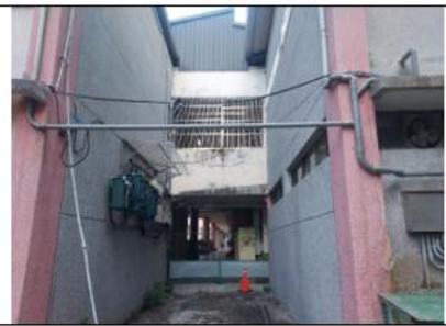
說明：校園屋頂導水管與儲水桶。
